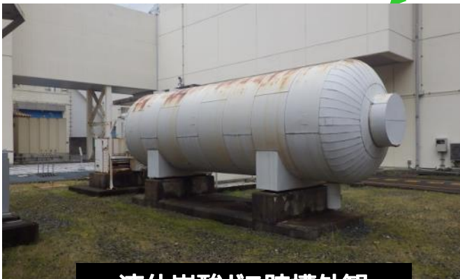
液体炭酸ガス貯槽外観
