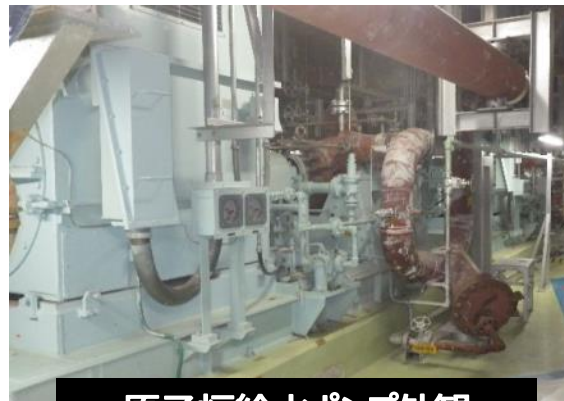
原子炉給水ポンプ外観
